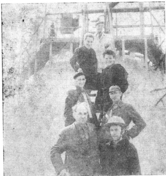
MZRiP — budowa zbiorników kulistych V = 600 m 3 — 1963 r. Na zdjęciu od góry: mgr inż. Wacław Brynk, inż. Jerzy Łempicki, mgr inż. Edward Wendt, Jan Kraśnicki, Ignacy Chmiel, Mieczysław Mańka, Stanisław Maciejewski.
