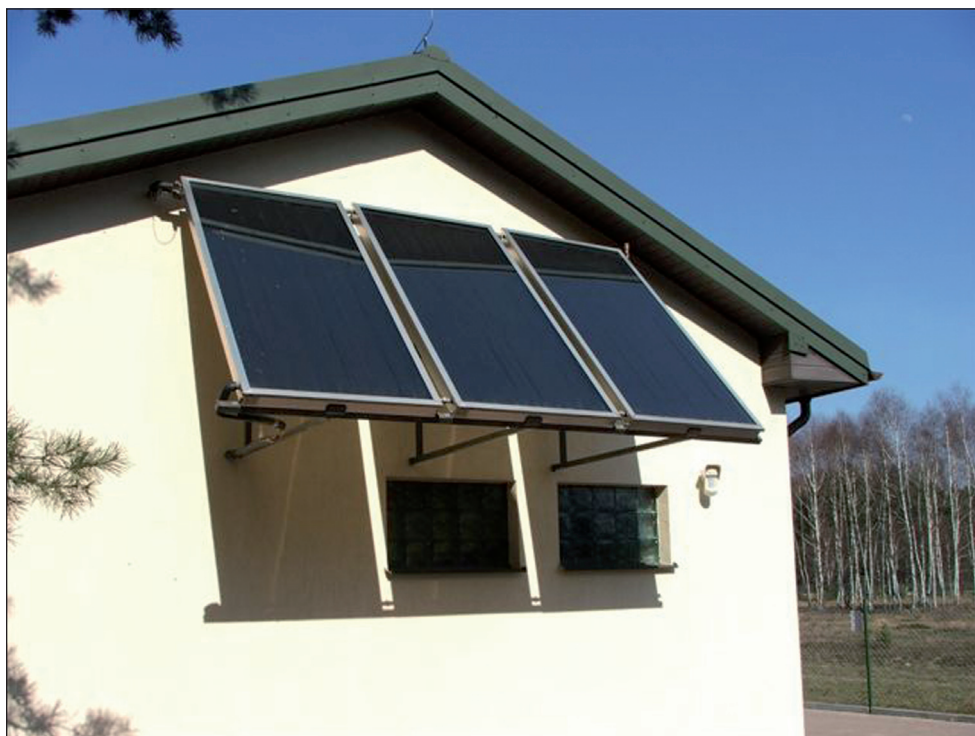
Fot 1. Baterie słoneczne – prywatny dom w Otwocku
