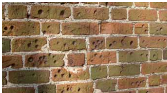
Dolki w murze kościoła, powstałe podczas rozpalania ognia w Wielką Sobotę.
