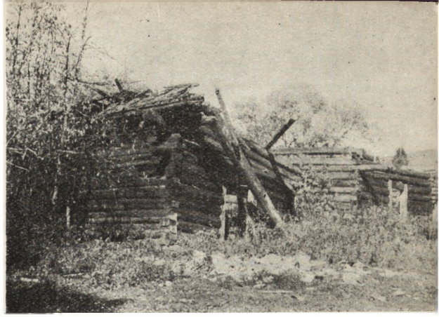
Ryc. 264. Zabudowania dworku Moniaków przed konserwacją.
