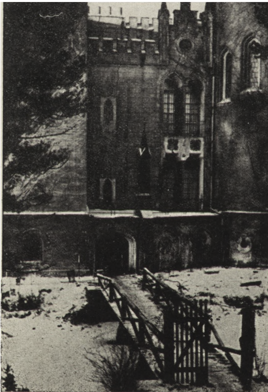
Ryc. 153. Zamek w Kórniku— pęknięcia i rysy na zewnętrznych murach zamku.
