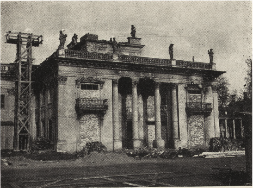
Ryc. 166. Zniszczona elewacja południowa po wykonaniu robót murarskich w 1945 r.
