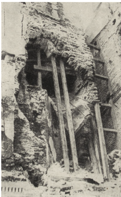
Ryc. 172. Zawalenie się ściany dzielącej salę jadalną od rotundy.
