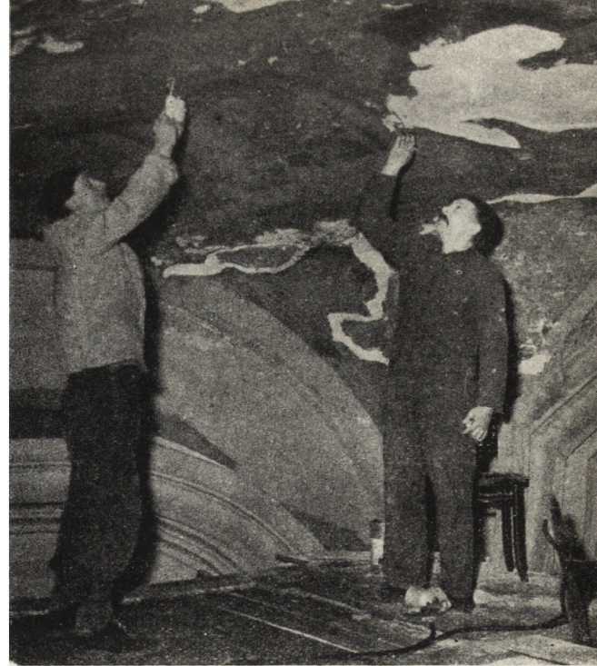
Ryc. 176. Praga — kościół św. Mikołusza. Zwilżanie tynku natryskami z emulsji wapiennej umacniającej podkład przed rozpoczęciem konserwacji uszkodzonych fresków.
