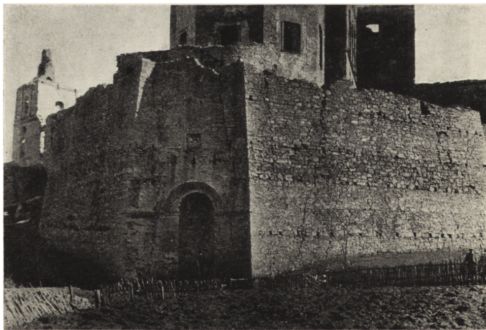
Ryc. 73. Zamek Krzyżtopór w Ujeździe. Rysy na obsuwającym się bastionie skutkiem podmycia fundamentów. 1959 r.
