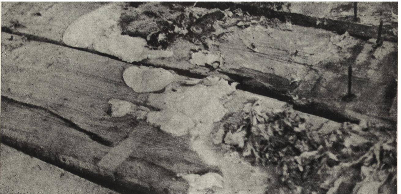
Ryc. 3. Kościół w Grywałdzie, zagrzybione deski podłogowe (fot. M. Walther)
