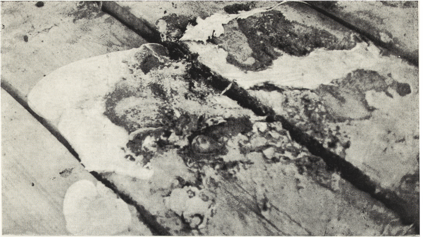
Ryc. 4. Kościół w Grywałdzie, zagrzybione deski podłogowe.
