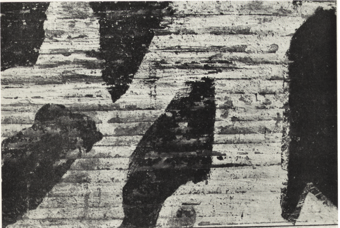
Ryc. 18. Dębno, kościół, nawa, ściana wschodnia — odpryski warstw malowidła
