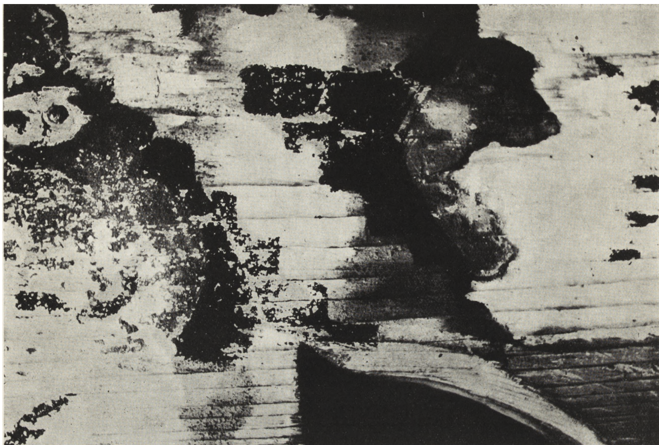
Ryc. 19. Dębno, kościół, nawa, koronka zaskrzynienia północnego — zabarwienie zaciekowe (makrofotografia; fot. J. Wróblewski)
