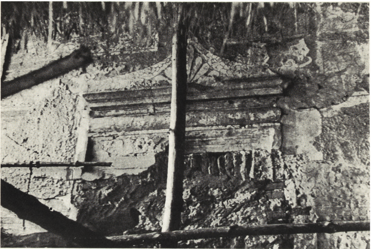
Ryc. 3. Działoszyn, zameczek, fragment dekoracji sgrafitto na elewacji wschodniej, stan przed konserwacją (fot. PKZ Warszawa — J. Szandomirski)
