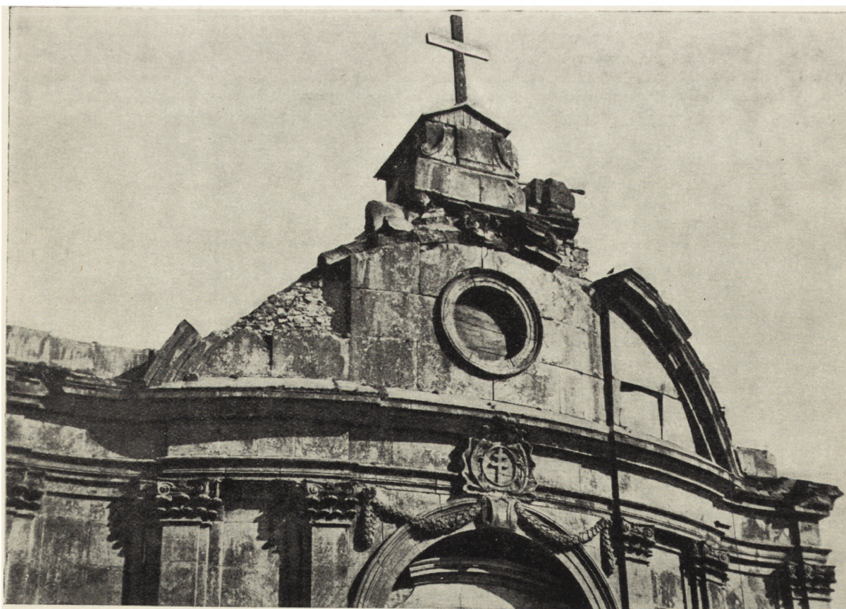
Ryc. 11. Święty Krzyż, szczyt fasady kościoła. Widoczne ubytki kamieniarki (fot. PKZ — J. Szandomirski)
