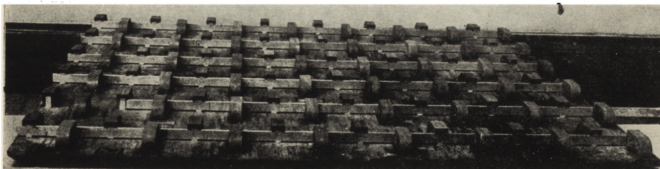
Ryc. 7. Parkiet drewniano-metalowy — widoczna wysunięta listwa stalowa
