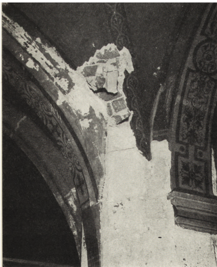
Il. 6. Lipsk. Kościół św. Tomasza. VI filar od wschodu ku zachodowi w rzędzie południowym z odsłoniętą powierzchnią piaskowca, nasiekana celem stworzenia przyczepności dla wyprawy z XIX w.
