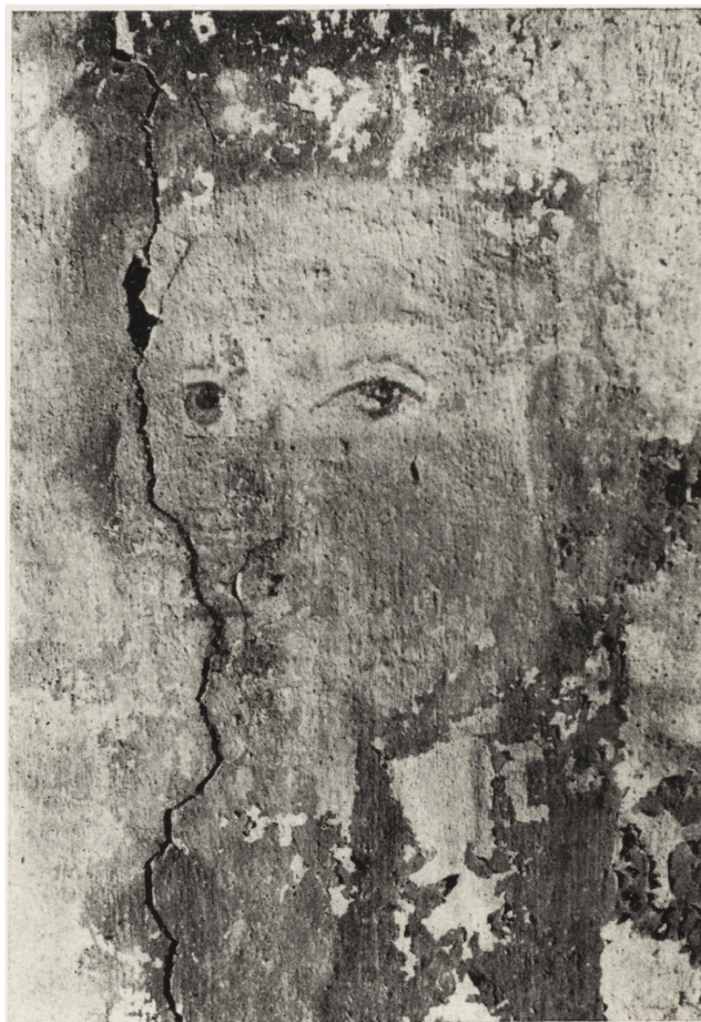
Il. 9. Oliwa. Katedra, południowa ściana prezbiterium, malowidło ściennie, fragment z widoczną łuszczącą się warstwą malarską. Przed konserwacją
