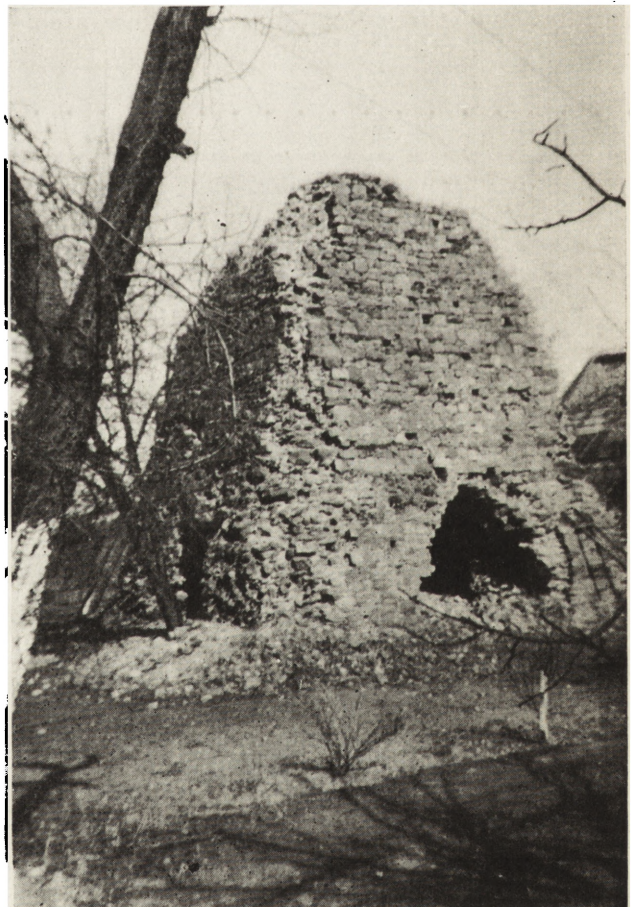
13. Kuźniaki (woj. kieleckie). Ruiny pieca hutniczego, stan w 1959 r. Obiekt ten jest przykładem postępującego niszczenia niezabezpieczonego zabytku (Fot. Pracowni Konserwacji Zabytków)
