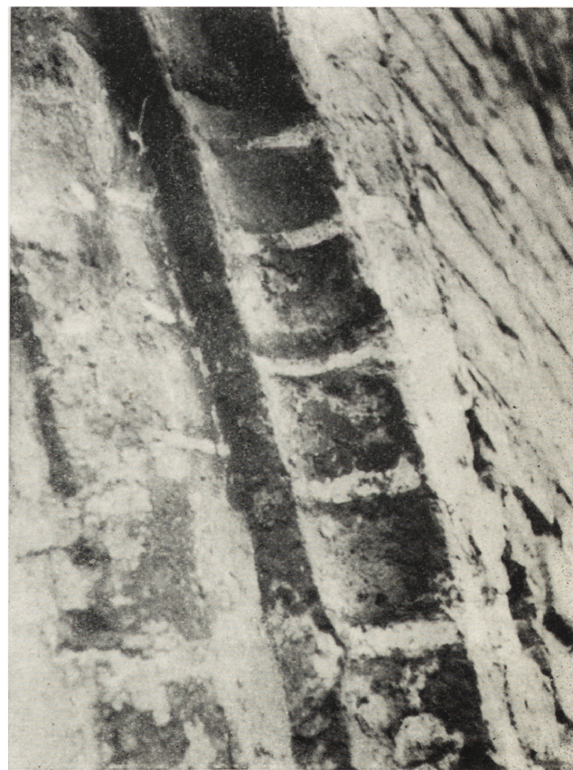
22. Wrocław. Klasztor bernardynów. Fragment gurtu w krużganku skrzydła wschodniego. Ceglane profile pokryte tynkiem-pobiałą i pomalowane czerwoną farbą z białymi paskami spoin (fot. autor)
