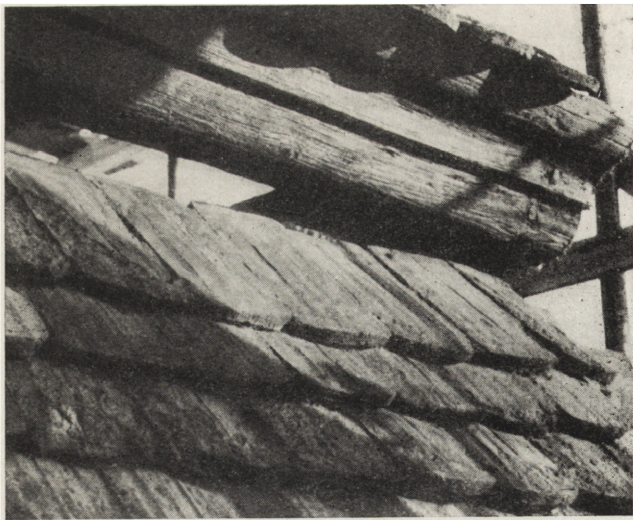
2. Deska okapowa w miejscu załamania dachu mansardowego, połącz zachodnia. Jedyne zachowane pierwotne element architektoniczny opracowany dekoracyjnie (fot. P. Garkiewicz)
