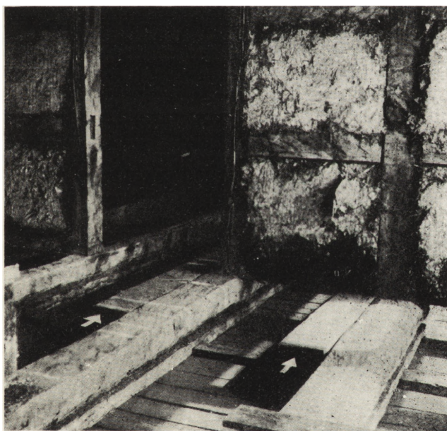
19. Prace przy stropie nad parterem. Zachowanie belek stropowych zniszczonych w partiach końcowych przez grzyb. Wprowadzenie elementów wzmacniających (oznaczonych strzałkami), związanych z belkami przy pomocy śrub i opartych na oczepach ścian działowej i zewnętrznej (fot. P. Gartkiewicz)
