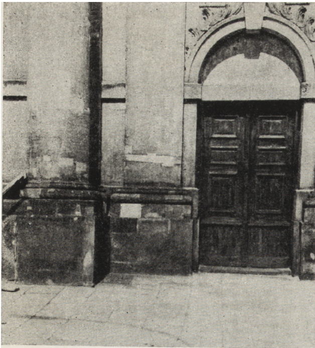
13. Warszawa. Kościół Wizytek. Szczerniałe cokoły kolumn i pilastrów pod wpływem przenikania kapilarnego wody i osadzania się zanieczyszczeń z powietrza, 1966 r.
