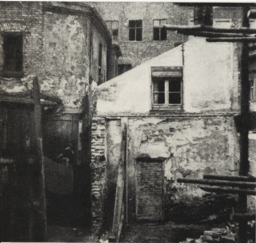
9. Toruń, oficyny przy budynku Rynek Staromiejski 35, które w ramach sanacji zostaną wyburzone (fot. J. Gardzielewska)
