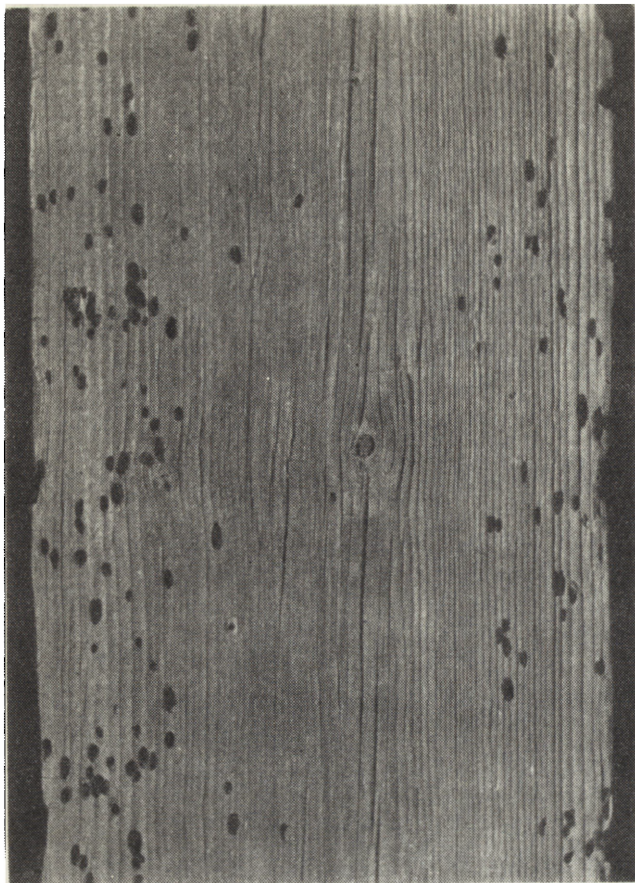
5. Drewno porażone przez owady spuszczela — Hylotrupes bajulus . Widoczne owalne otwory wylotowe (fot. S. Kinelski)
