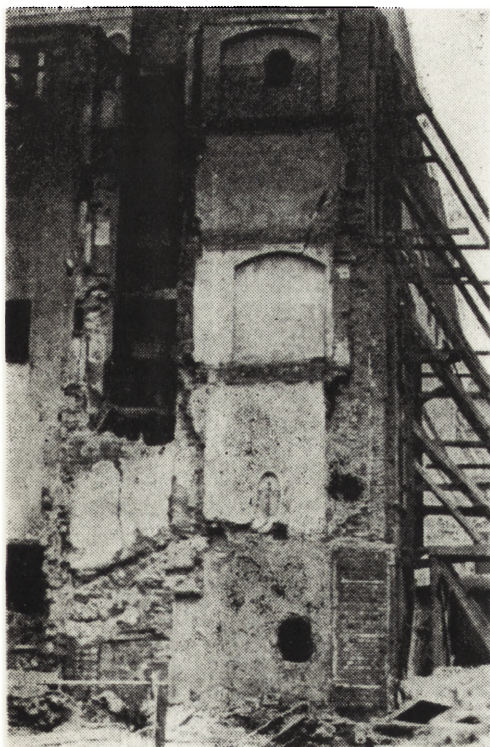
2. Legnica, dom „Pod Przepiórczym Koszem”, szczytowa ściana po awarii sąsiedniego budynku
