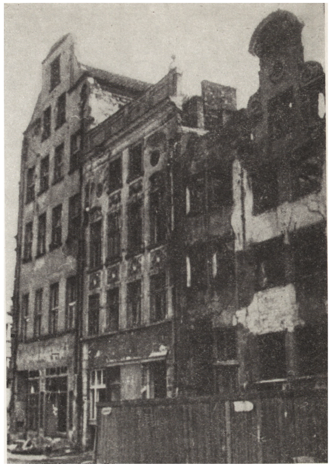
19. Gdańsk, ul. Straganiarska 32—29, stan w 1973 r. w trakcie prowadzonych badań architektonicznych przez PP PKZ — Oddział w Gdańsku; dwie kamieniczki po prawej zostały rozebrane w 1974 r., obecnie w odbudowie (fot. autor)
