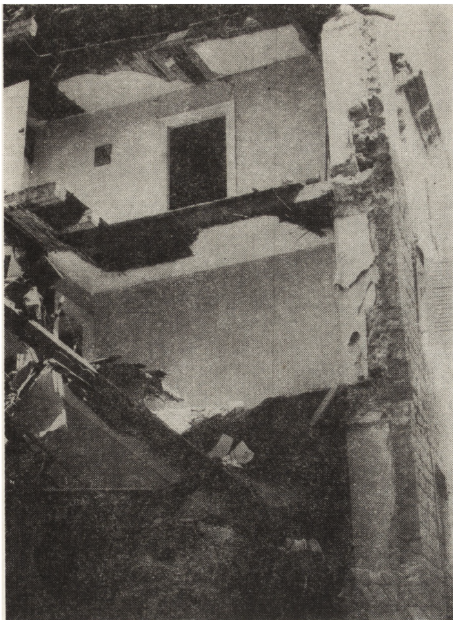
4. Budva, zrujnowany dom mieszkalny
