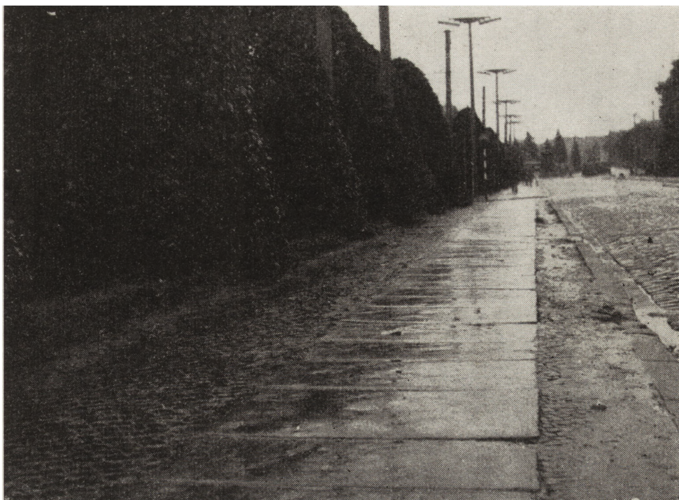
7. Grudziądz, stary kamienny chodnik, ujęty kostką bazaltową przy ul. 23 Stycznia (fot. A. Gruszecki)
