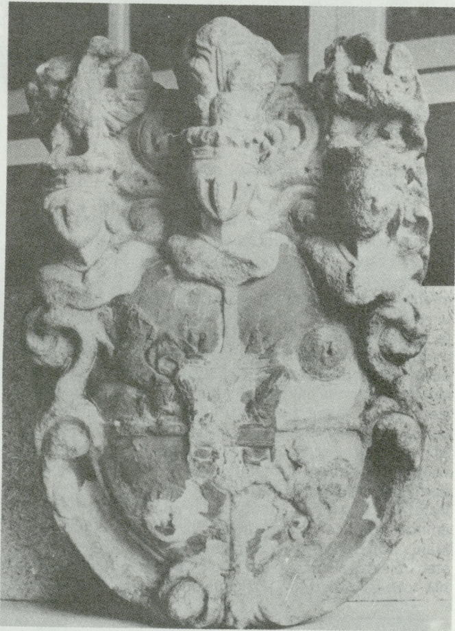
1. Szkodliwe nawarstwienia (grubość od 1–2 mm) na kartuszu marmurowym o podłożu silnie spękanym i scukrzonym w miejscach, gdzie czarna „skorupa” nawarstwień odpadła
