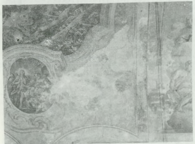
3. Scena Zmartwychwstania , medalion po stronie północnej przed konserwacją. Widoczne rozległe zasolenia i zabielenia warstwy malarskiej, ubytki, odstawania, spudrowania warstwy malarskiej i zaprawy
