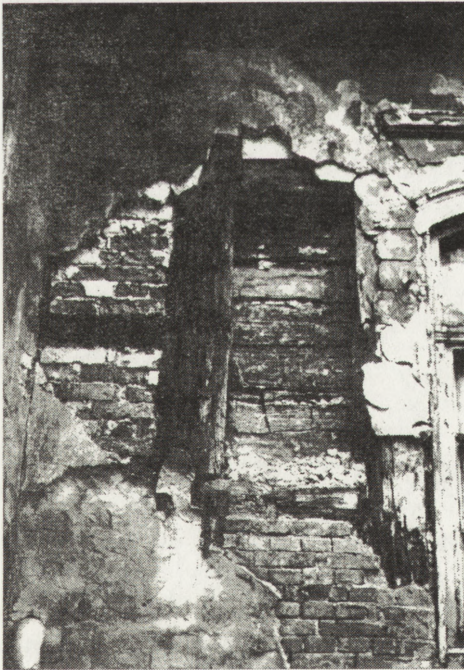
11. Fragment elewacji północnej przy ryzalicie salonu. Z lewej widoczny słup z ryglem, pośrodku wewnętrzne sumiki, z prawej przy oknie podtynkowe dachówki, a na dole uzupełnienie muru z cegły. Jest to najbardziej zniszczony fragment ścian zewnętrznych dworu 11. Fragment of northern facade, near the projection of the drawing room. On the left — pillar with brickwork, in the centre — inner beam, on the right — roof tiles near the window, at the bottom — brick supplementation of wall. This is the most devastated fragment of the outer walls of the manorhouse
