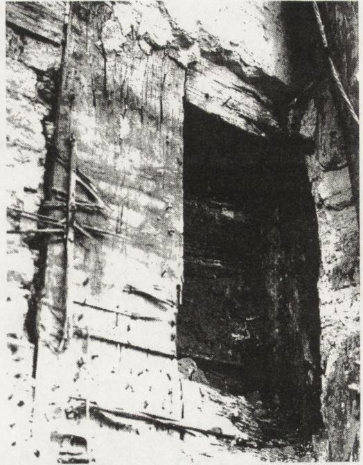
10. Fragment ściany fasady przy ryzalicie wejściowym. Z lewej słup z odcinkami rygli, pośrodku, w głębi, widoczne poziome sumiki po wypadnięciu ceglano-fachu 10. Fragment of facade wall near the entrance projection. On the left — pillar with fragments of brickwork, in the middle — horizontal beam, after the loss of brickwork
