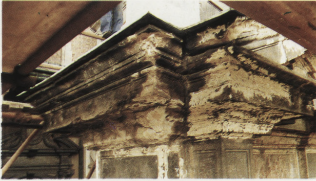
D. Brama południowa, zniszczenia gzymsów (złuszczenia) w miejscach podciekania wody opadowej, stan przed konserwacją D. Southern gate; decay of cornices (flaking) in the places affected by rain water, state prior to conservation
