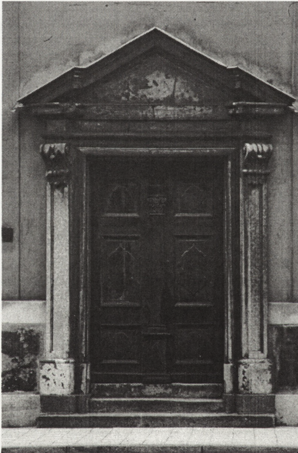
1. Wyraźny nalot gipsu na pilastrach portalu znajdującego się na zewnętrznej ścianie kościoła św. Ducha w Toruniu. Wszystkie zdjęcia wykonał A. Skowroński
