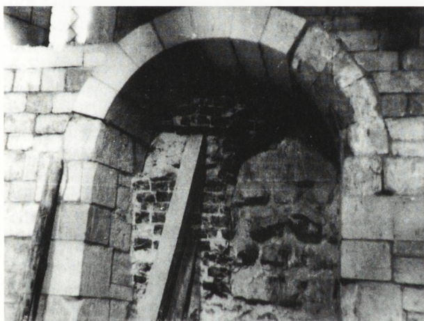
12. Portal północny po rekonstrukcji łuku w 1956 r. 12. Northern portal after the reconstruction of the arch in 1956
