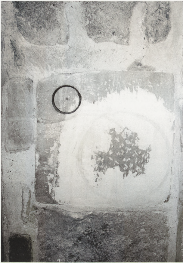
6. Ślady po niefortunnie wykonanych odwiertach w 1998 r. w filarach celem pobrania materiału budowlanego do badań. Fot. R. Stasiuk, grudzień 1998 r.
