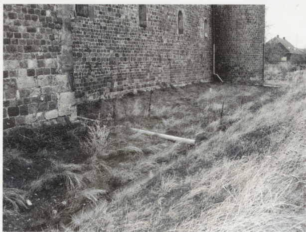
2. Fragment murów archikolegiaty od strony południowej. System odprowadzania wody opadowej gromadzącej się w dolnych partiach murów. Fot. R. Stasiuk, grudzień 1998 r.
