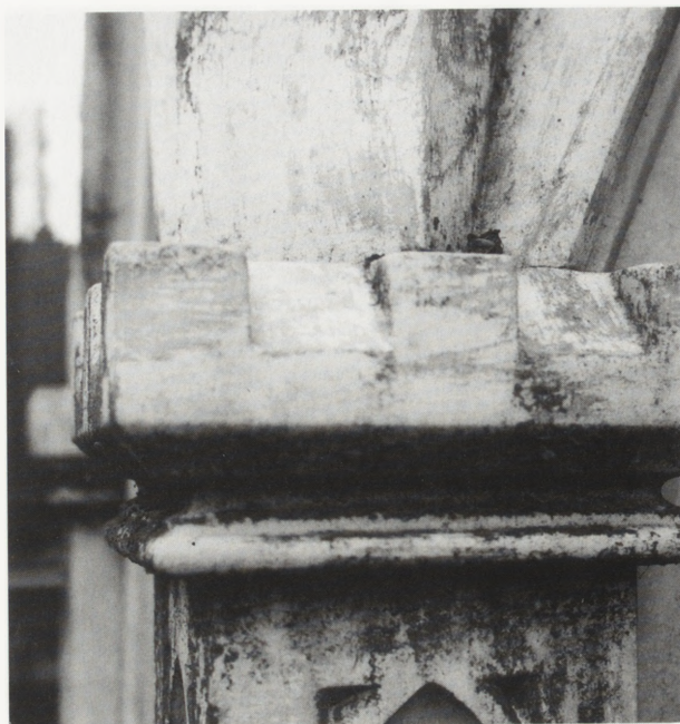
7b. Zmiany estetyczne na powierzchni krenelażu jednej ze ścian pomnika wywołane procesem wietrzenia kalcytu na skutek utraty szczelności powłoki zabezpieczającej z roztworu żywicy B-72, strona zachodnia — zbliżenie. Fot. W. Procyk
