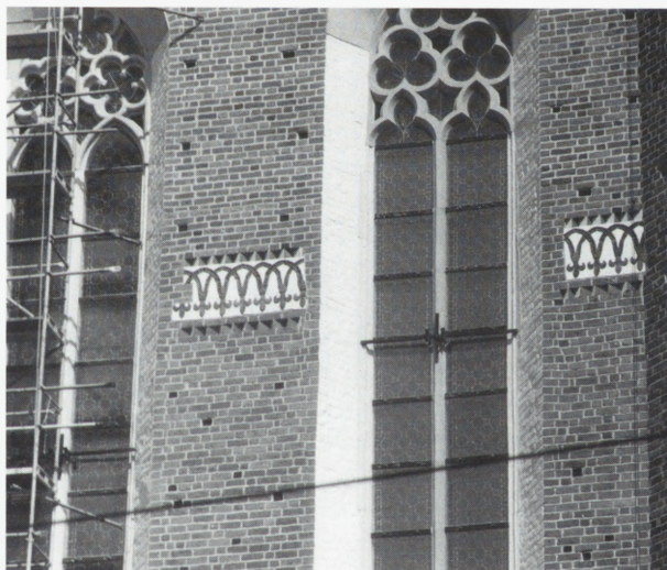
8. Kościół oo. dominikanów w Krakowie. Fragment płd. elewacji prezbiterium z widocznym fryzem arkadkowym ujętym fryzami zębatymi. Stan z 2000 r. (po konserwacji). Fot. P. Dettloff
