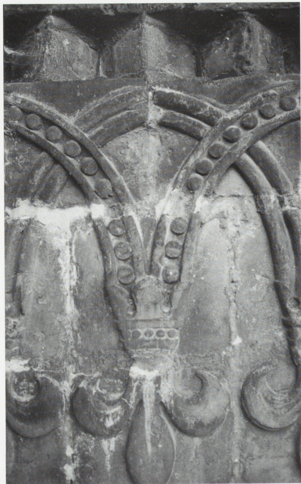
2. Kościół oo. dominikanów w Krakowie. Fragment fryzu arkadkowego elewacji prezbiterium. Stan z 1998 r. (przed konserwacją). Fot. M. Szyma
