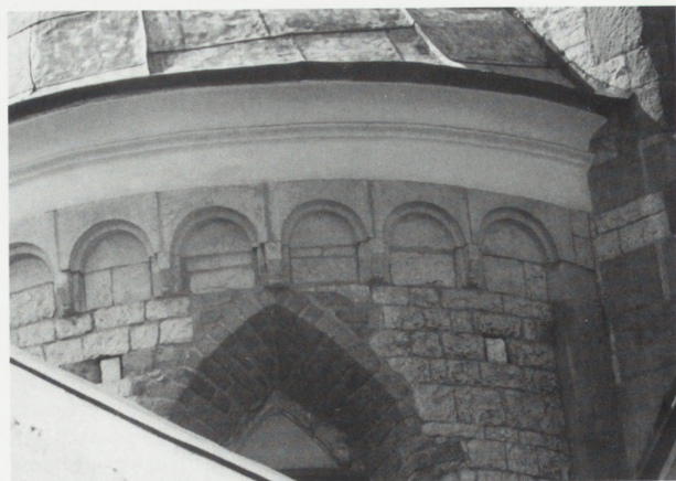
3. Kościół św. Andrzeja w Krakowie. Fragment fryzu arkadkowego elewacji prezbiterium. Stan z 2000 r. Fot. P. Dettloff
