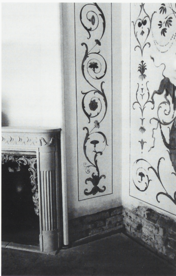
5. Fragment wnętrza po konserwacji polichromii i kominka, przed wykonaniem izolacji poziomej ścian wewnętrznych. Fot. R. Gazda, 2000
