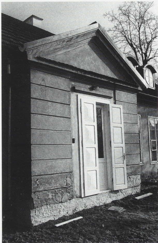
4. Ściana zewnętrzna po wykonaniu izolacji. Fot. R. Gazda, 2000 4. The outer wall after insulation. Photo R. Gazda, 2000
