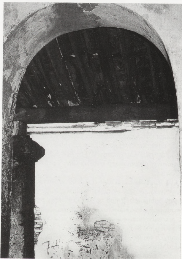
6. Pulpitowy daszek nad bocznym wejściem do świątyni The Mieu opanowany przez grzyb Antrodia serialis i w mniejszym stopniu przez grzyb Peniophora purpurea
