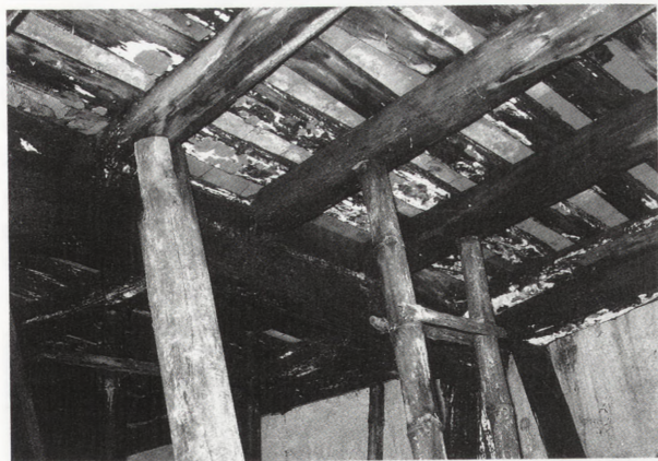
1. Konstrukcja dachu małego budynku koło świątyni The Mieu oprowadzona przez grzyb Serpula lacrymans . Wszystkie fot. A. Krajewski, XII 1996
