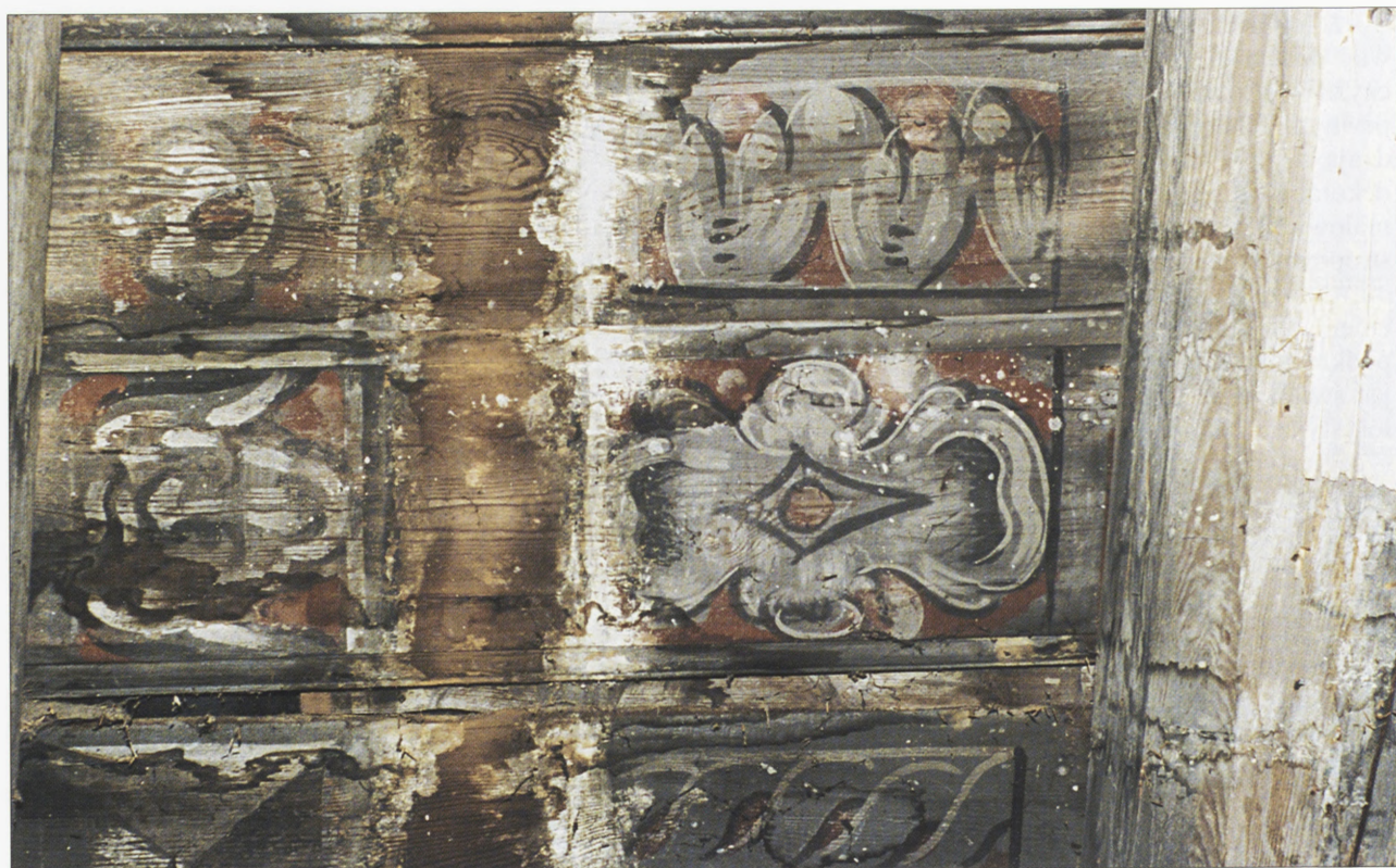
5. Wielka sala na pierwszym piętrze z odkrytymi malowanymi dekoracjami stropu. W miejscu, gdzie dawniej znajdowała się ściana, widoczny pośrodku pas bez polichromii. Świadczy to o wcześniejszym innym podziale wnętrza 5. Great chamber on the first floor with uncovered painted decoration of the vault on the spot which formerly contained a partially visible strip, testifying to a different earlier division of the interiors
