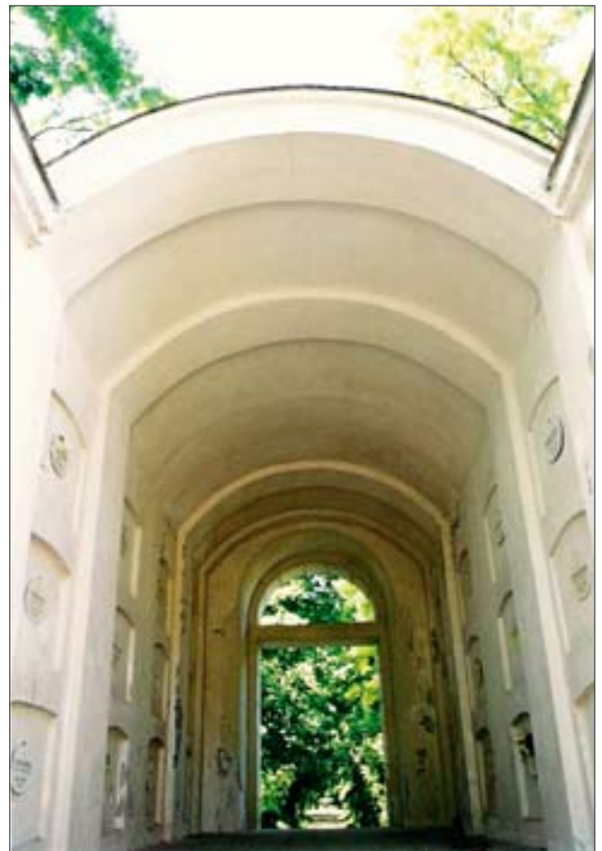
3. Trakt komunikacyjny dwóch najstarszych części katakumb; w głębi katakumby wzniesione przez arch. Z. Tillingera, zamknięte pierwotnie ścianą, której ślad pozostał pomiędzy drugim a trzecim pilastrem, licząc od widocznego na pierwszym planie. 3. Communication courses in the two oldest parts of the catacombs; in the background: catacombs built by architect Z. Tillinger, originally closed by a wall whose traces remains between the second and third pilaster, counting from the one visible in the foreground.
