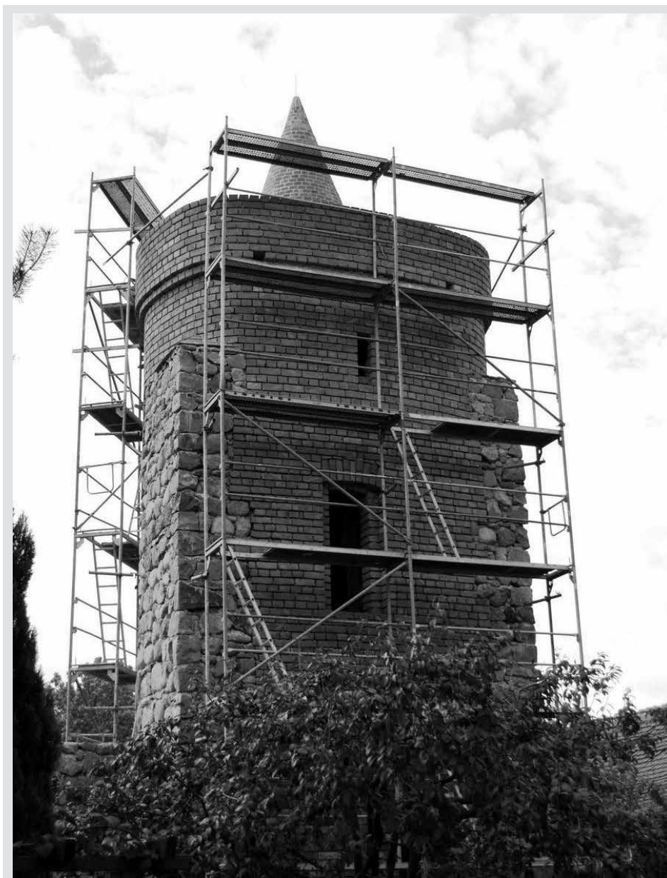
Ryc. 12. Baszta Lodowa podczas odbudowy (fot. Marcin Czeszyk, stan z 2012 r., za: http://www.trzcinsko.com )
