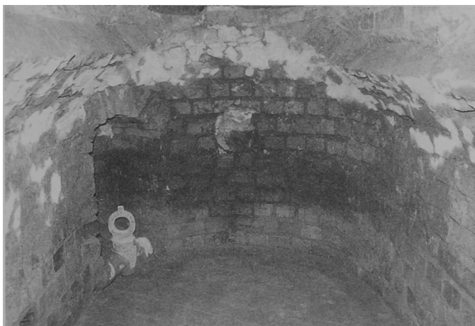
Fot. 1. W narożniku południowo-wschodnim studzienki znajduje się wnęka z kurkiem, a pośrodku kolistej ściany widoczna jest zaczopowana rura kanalizacyjna. Fot. L. Kotlewski
