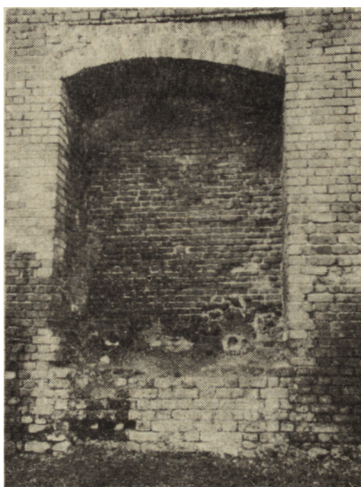
Ryc. 19. Łęczyca, pozostałość po bramie na bastion „zamkowy” we wschodnim murze zamkowym
