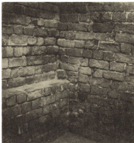
Ryc. 10. Łęczyca, to samo odspojenie w partii fundamentowej
