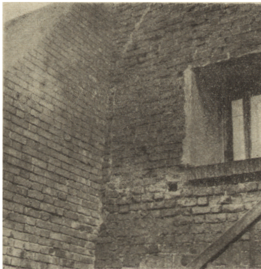
Ryc. 9. Łęczyca, odspojenie północnej ściany „domu starego” od muru
