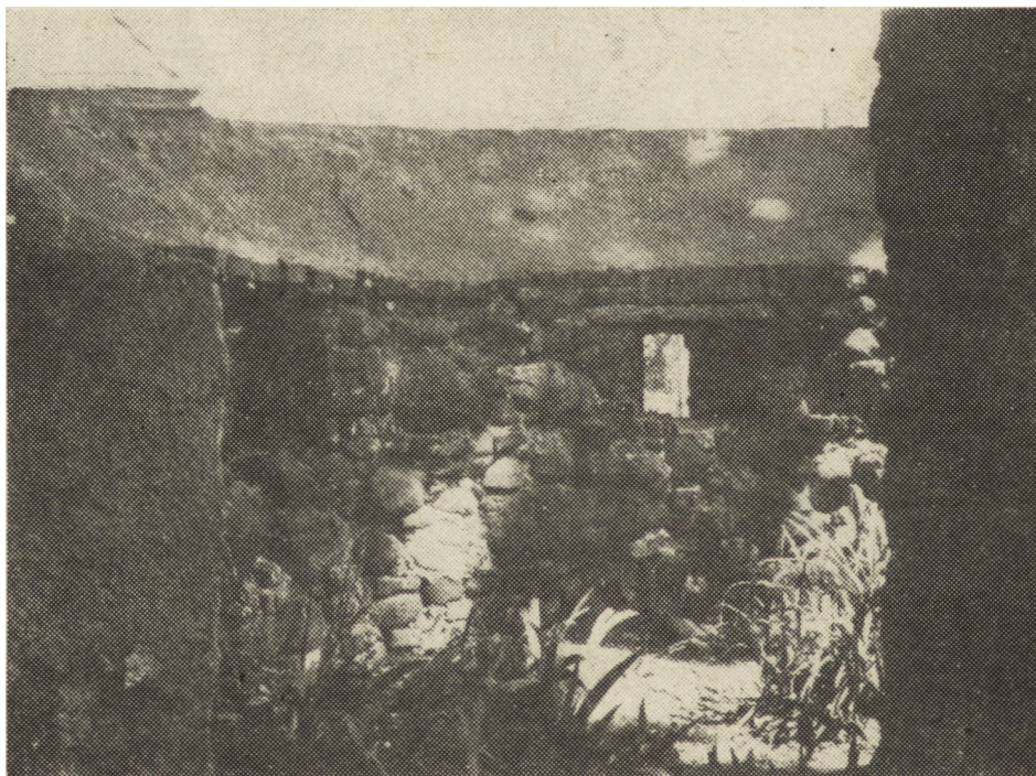
Ryc. 25. Lutynia. Mur obronny przykościelny, basteja północno-wschodnia od wnętrza. Widok od SW. Fot. Tadeusz Poklewski
