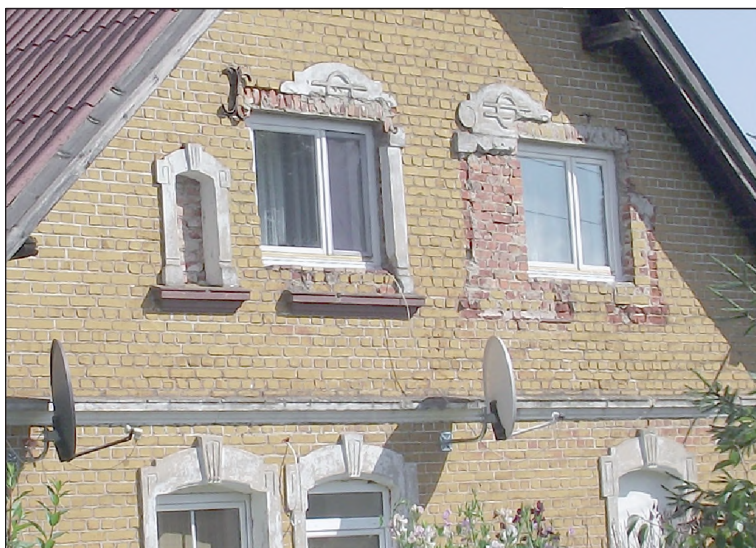
Rys. 3. Ubożenie elewacji budynku mieszkalnego w wyniku niewłaściwego umiejscowienia nowych otworów okiennych, Durąg, wrzesień 2011 r. (fot. archiwum KNAK „Horyzont”) Fig. 3. Depletion of the facade of a residential building due to improper siting of new window openings, Durąg, September 2011 (phot. KNAK „Horyzont”)
