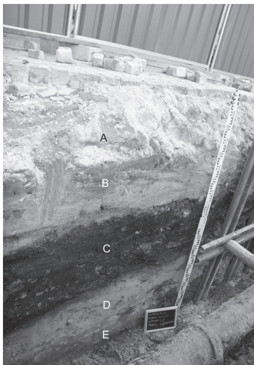
Fot. 5. Rynek Starego Miasta w Warszawie. Układ nawarstwień użytkowych rynku zadokumentowany w wykopie pod wymianę magistrali wodociągowej. A – podsypka współczesna, B – warstwy niwelacyjne, XVI-XVII w., C – nawarstwienia użytkowe rynku, XIV-XV w., D, E – warstwy naturalne (calec)
