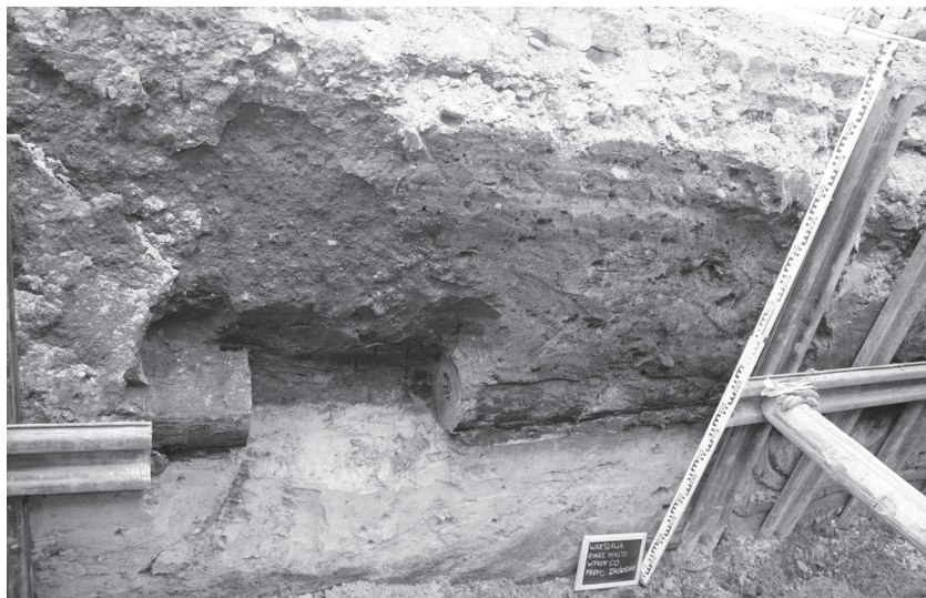
Fot. 6. Rynek Starego Miasta w Warszawie. Drewniana rura wodociągowa z I połowy XVII w. w wykopie pod wymianę magistrali wodociągowej
