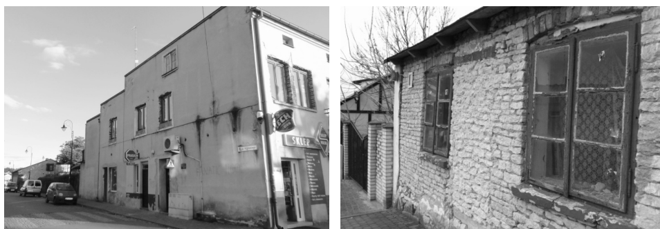
Ryc. 8. Niski standard zabudowy i zły stan techniczny obiektów historycznych (ewidencja zabytków) wzdłuż ulicy Tureckiej. Tradycyjny materiał – biały kamień łączony z czerwoną cegłą (fotografie autorki)
