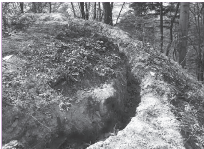
1. Krajowice. Relikty zamku Goleisz. Przykład dewastacji nawarstwień archeologicznych – wykop odsłaniający podziemną partię murów zamku, kwiecień 2009. Fot. I. Malawska.
