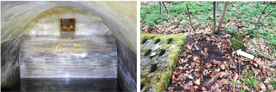
Ryc. 18. Z lewej – zbliżenie na ścianę z otworem wentylacyjnym, widoczny ubytek tynku, odsłaniający cegły; z prawej – miejsce wyprowadzenia kanału wentylacyjnego na powierzchnię (fot. M. Klugmann)
