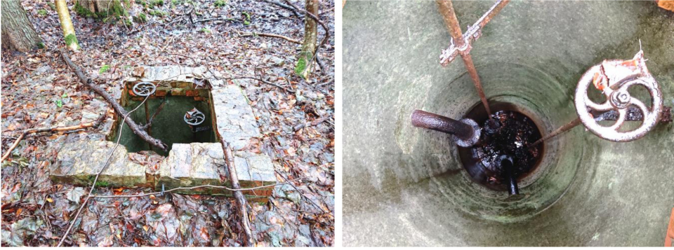
Ryc. 8. Studnia drenażowa nr 2; widoczne pokrętła rurociągów odcinających połączenie ze studnią nr 3 i ze studnią nr 5 (por. plan, Ryc. 4) (fot. M. Klugmann)
