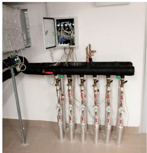
Ryc. 5. Kolektory układu pionowych wymienników gruntowych
