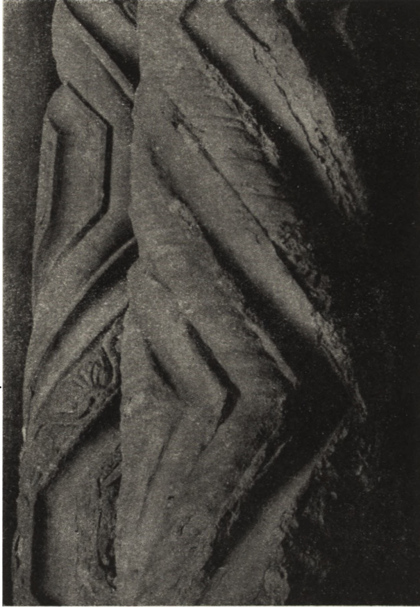
Ryc. 192. Strona wschodnia — fragment trzech trzonów. Najsilniejsze zniszczenie występuje na zewnątrz, maleje ku wnętrzu portalu i ku górze.
