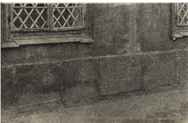
Ryc. 100. Osuszanie muru rurkami porowatymi (pałac Wallensteina w Pradze).
